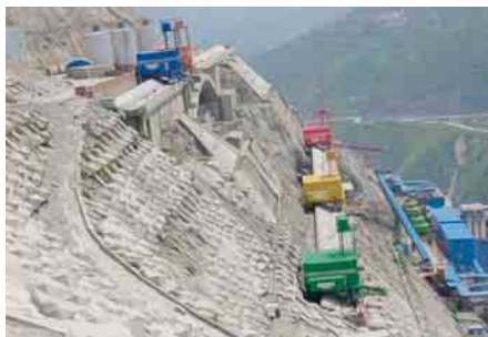
5 Parallel fahrbare Kabelkrane
